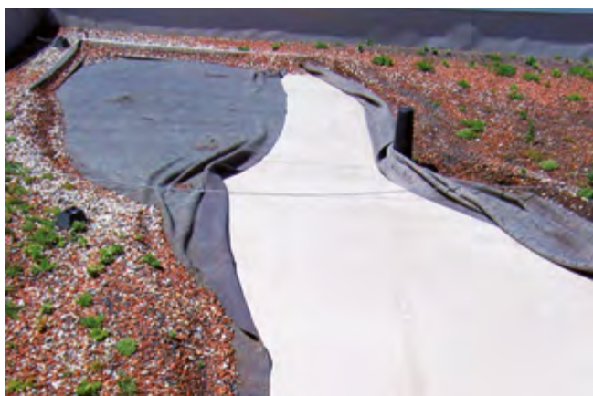
▲ Windschade, wegwaaien net aangebracht substraat en plugplanten.
